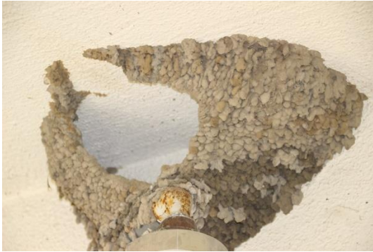
図 93 破損したコシアカツバメの巣
