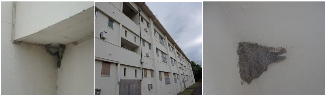
図 106 小田原市鴨宮におけるコシアカツバメ破損巣と営巣建物
