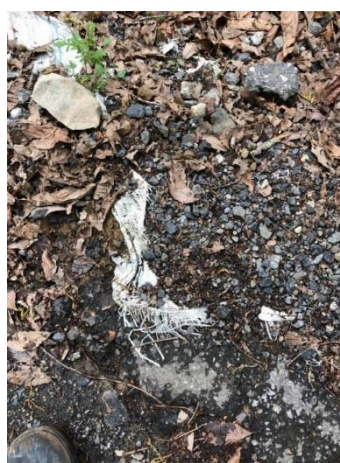
写真 31 【風雨にさらされて破損して流出した土嚢】
