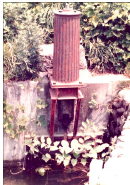
写真 II-3-6-4 取水口を上下させる装置(カバー内)の下に「差蓋」がみえる。その下に現在の「取水口」がある。
