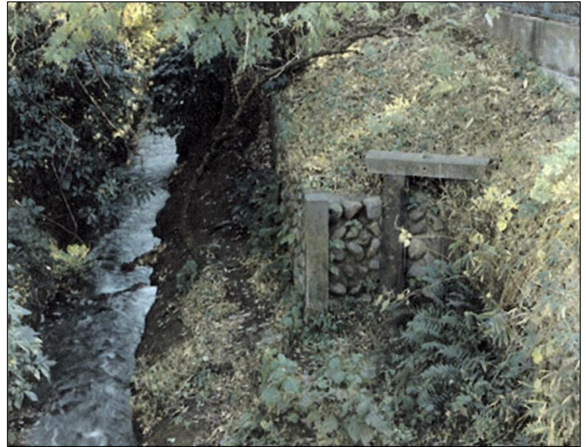
写真II-3-12-2 玉川上水路護岸を切り込むようにつくられている鳥山分水口の空間。
