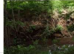
井の頭公園下流部水路：流路も少なくなり、水路適正の崩落、樹木の繁茂が進む。
