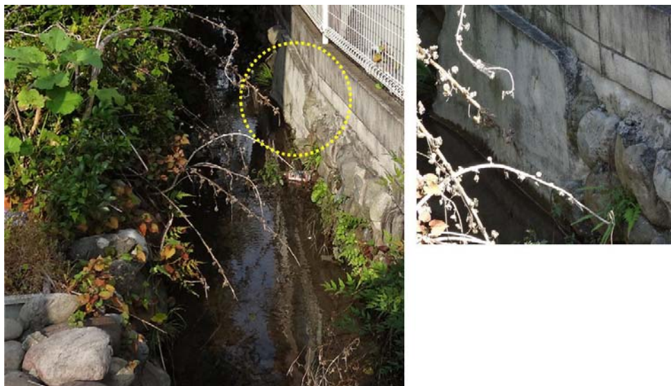
写真-36 玉石積補修の現状
