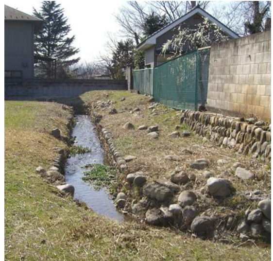
写真-32 崩れたまま放置されている玉石積
