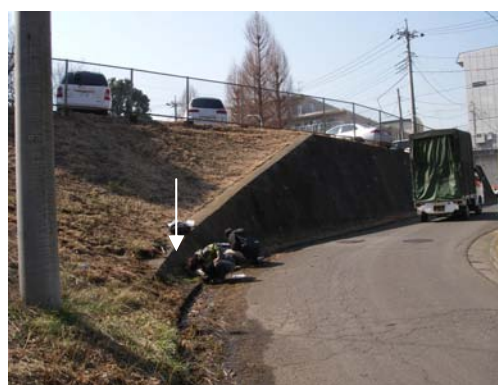
d) St. 22 平湧水 漏水のような湧水(矢印)から地下水種が確認された (2006年2月14日)
