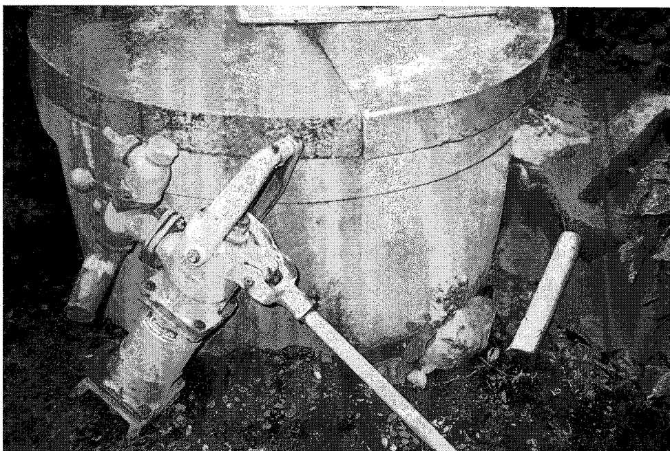
9. 現在使用していない井戸
