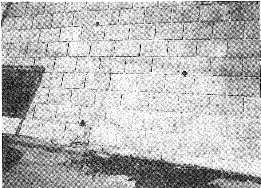
↑ 水抜きパイプから水が出ている
