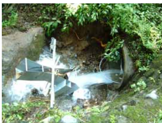
写真 9.1 下流堰の破壊
