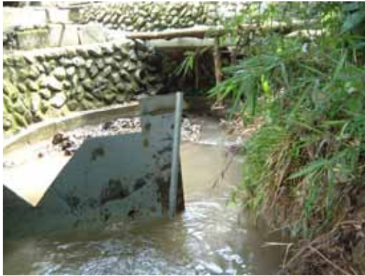
写真 9.3 樽沢最下流堰の破壊状況
