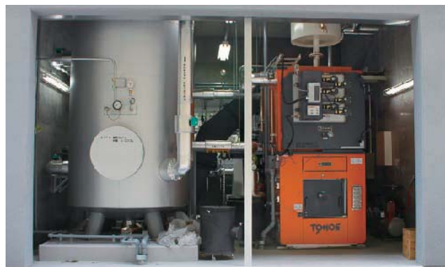
奥多摩温泉もえぎの湯へ導入された木質バイオマスボイラー
