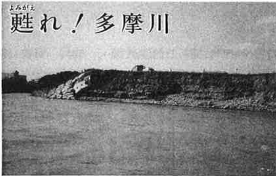
洪水で流された低水護岸 (中央高速道路橋上左岸 8月28日撮)
