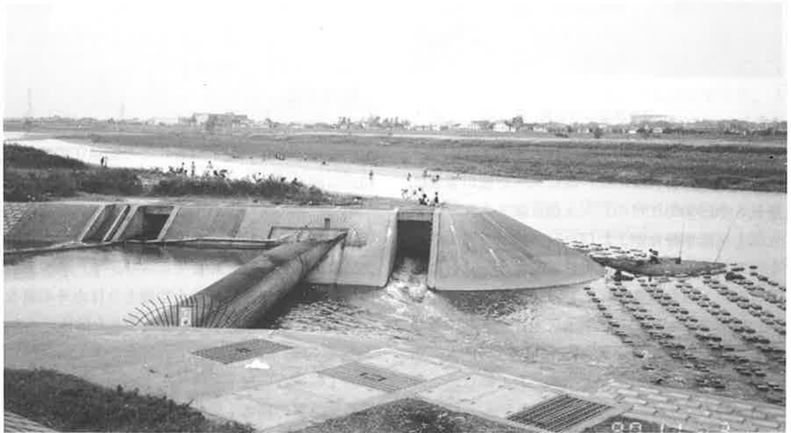
多摩川右岸 平瀬川の水質を浄化する目的で作られたファブリダム
