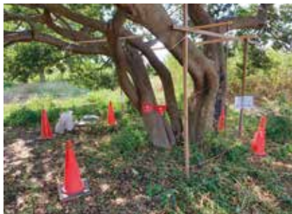
壊れて修理中のツリーハウス
