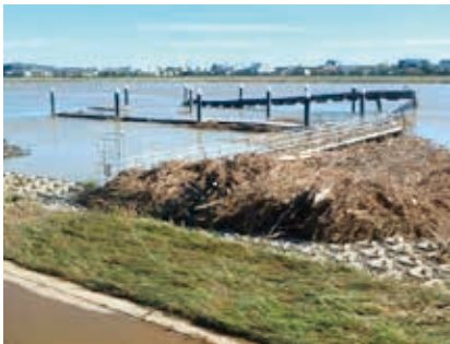
多摩川 2.3k 左岸 (東京都大田区) 棧橋流失
