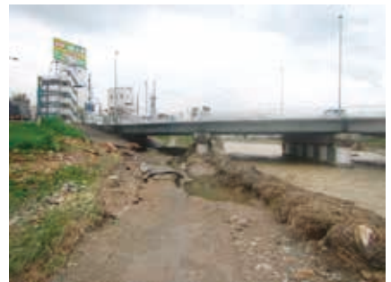
浅川 11.4k 右岸 (東京都八王子市) 河岸侵食 L=110m
