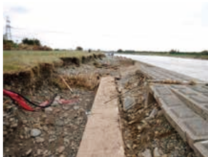
多摩川 30.6k 左岸 (東京都府中市) 低水護岸崩壊 L=200m
