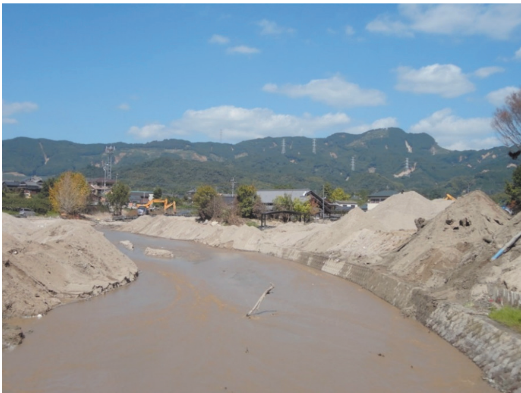
2017年7月 九州北部水害における朝倉市赤谷川の水・土砂災害
